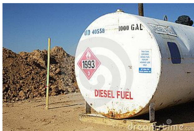
Foto referencial - almacenamiento de combustibles en etapa de operación.
